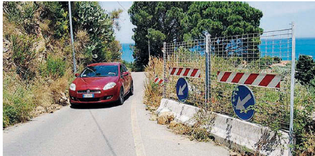
La strada comunale. Dopo il dissesto è possibile transitare solo in uno spazio ridotto
